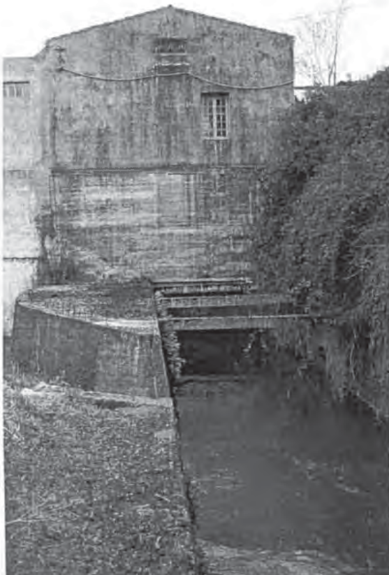
Canal de desagüe de una turbina de producción eléctrica en Santa Cruz de Iguña. En la actualidad abastece de dicha energía a la empresa láctea Morais S.A. establecida en la Serna de Iguña.
